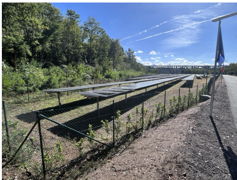
Fig. 2 – Il parco fotovoltaico nel fondovalle dell'Olona; sullo sfondo il viadotto che attraversa la valle.
