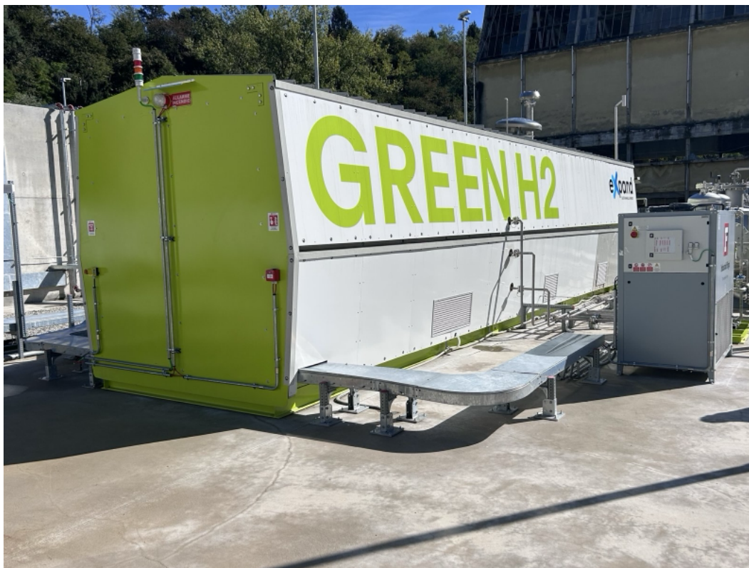
Fig. 3 – Il container dell'elettrolizzatore «GREEN H2» con l'unità di raffreddamento.
